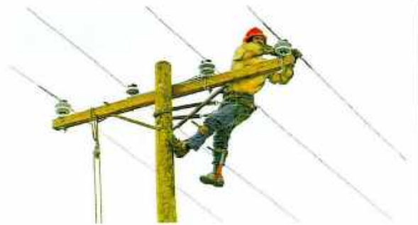
Hình 79: Nguy cơ tai nạn điện giật
